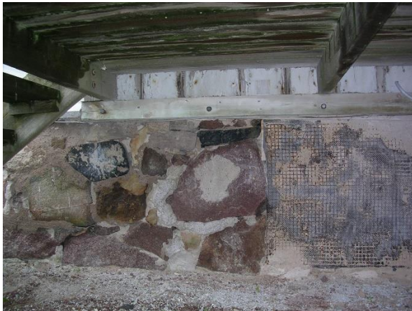
Bild på äldre och yngre byggnadskroppars olika socklar, t.v. av natursten och t.h. reveterat timmer. (Idag syns mest nätet som använts för att få putsen att fästa.)
